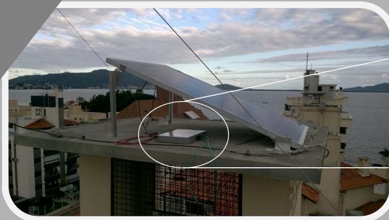
Protótipo do microinversor instalado
